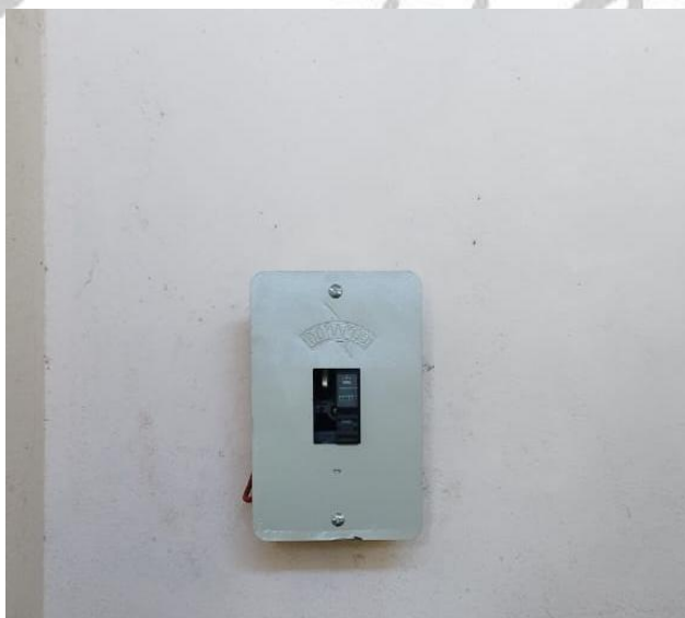
Caja térmica monofásica a 3 hilos ,125 a por polo 220 v 2 puntos (sobre puesta) incluye breakers
