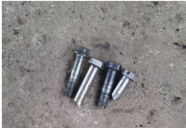
PERNOS DE SUJETACION DEL TANQUE HIDRÁULICO 6
