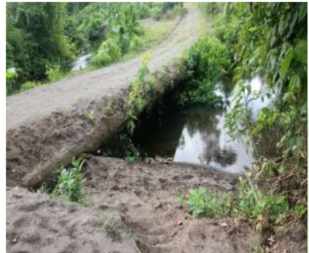
Fotografía 2-88: Estado de puente de madera/ Foto: Recorrido en campo PDOT 2020
