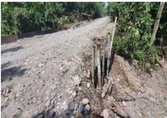
Fotografía 2-87: Estado de puente de tubería reciclada/ Foto: Recorrido en campo PDOT 2020
