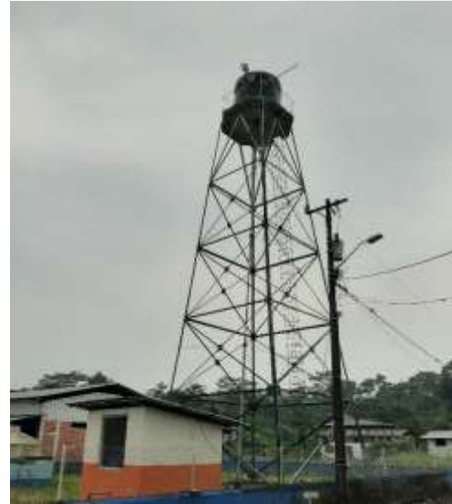
Fotografía 2-75:: Tanque elevado de agua /Comunidad Sardinas/ Foto: Recorrido en campo PDOT 2020
