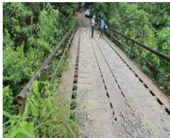
Fotografía 2-85: Estado de estructura de rodadura de puentes / Foto: Recorrido en campo PDOT 2020
