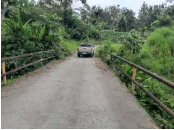
Fotografía 2-86: Estado de puente de tubería reciclada/ Foto: Recorrido en campo PDOT 2020
